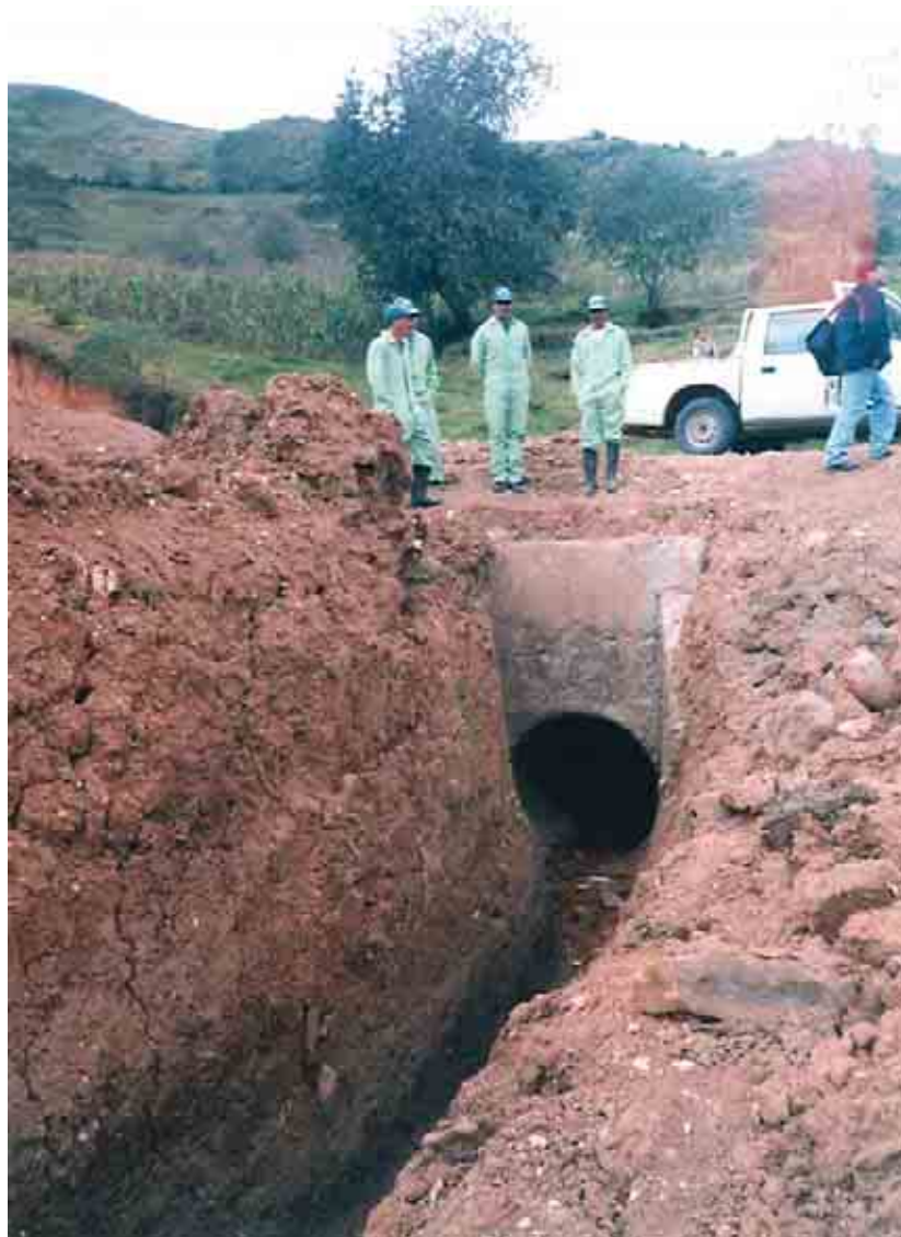
Figura 13: Alcantarilla recién desbloqueada
