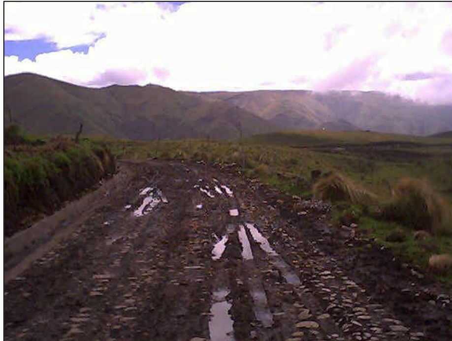
Empedrado ejecutado sobre Subrasantes inadecuadas (CBR < 6%)
