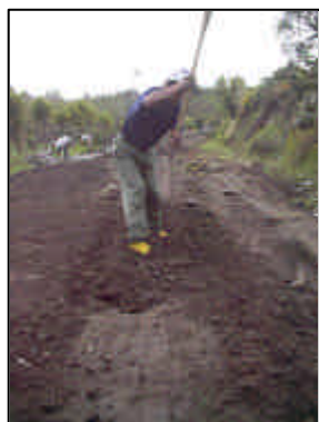
Disgregación de Subrasante
